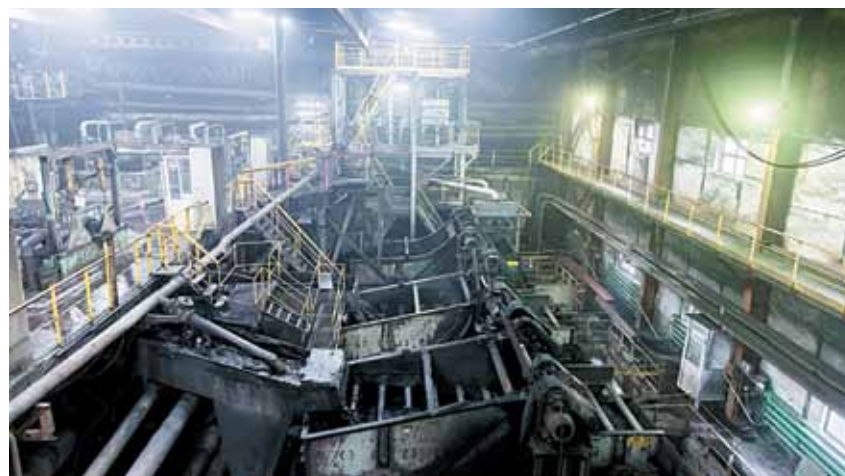
Инвестиции РУК. Комплекс нового оборудования ЦОФ «Кузнецкая» помогает повысить качество концентрата
